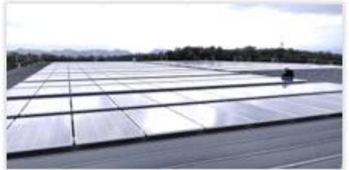
久居工場の屋上に設置した太陽光発電パネル
